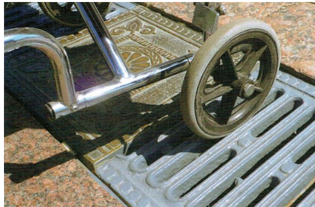
Rejillas de alcantarillado que atascan la silla de ruedas
