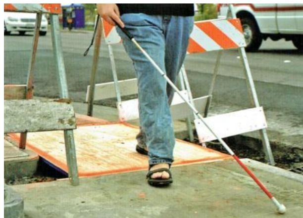
Obras imprevistas que son difíciles de diferenciar por la textura del pavimento
